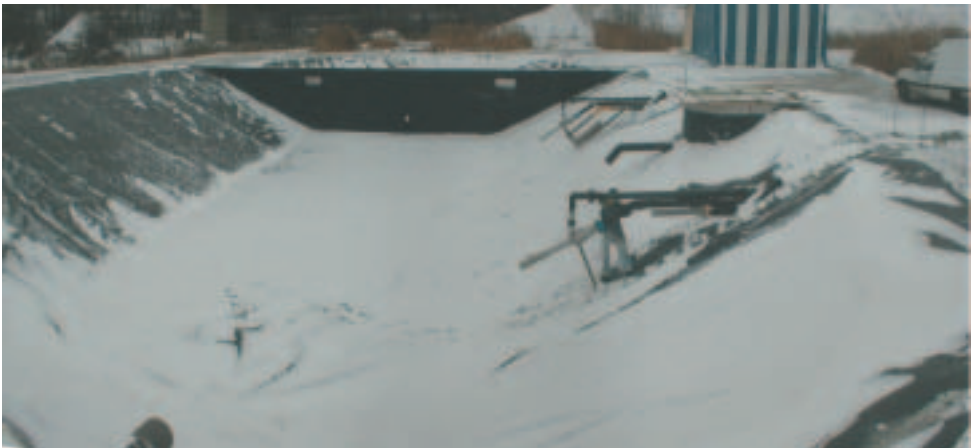
Umgebauter Klärteich mit Injektorbeflüftung (Stand: Dezember 2001)
