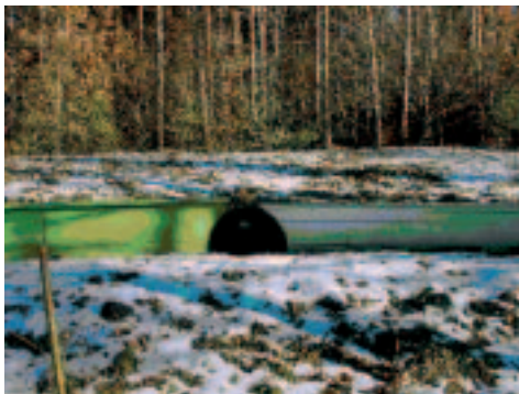
Durchlass (ø 600 mm) und Leitwand aus Stahl
