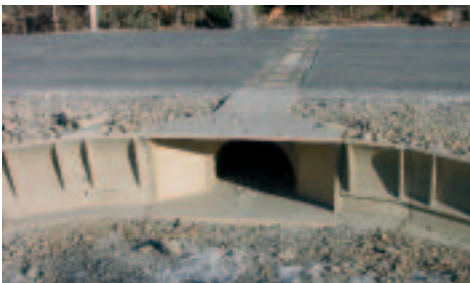
Durchlass aus Polymerbeton, geschlitzt. Leitwand aus Kunststoffelementen.
