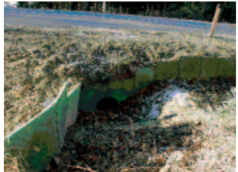
Leitwandssystem aus Kunststoffplatten, Schwerlastrohr, \varnothing 400 mm, als Amphibiendurchlass.
